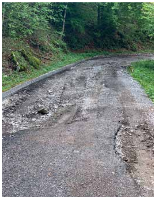
1. Strada Faedis - Canebola prima dell'intervento di rifacimento del manto. Si notano gli evidenti ammaloramenti
